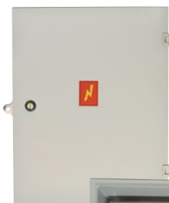
Quadro de força fechado
