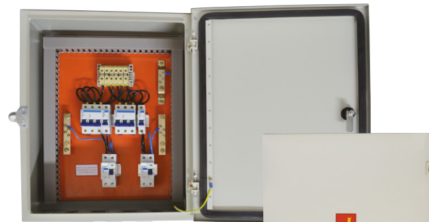
Quadro de força aberto
