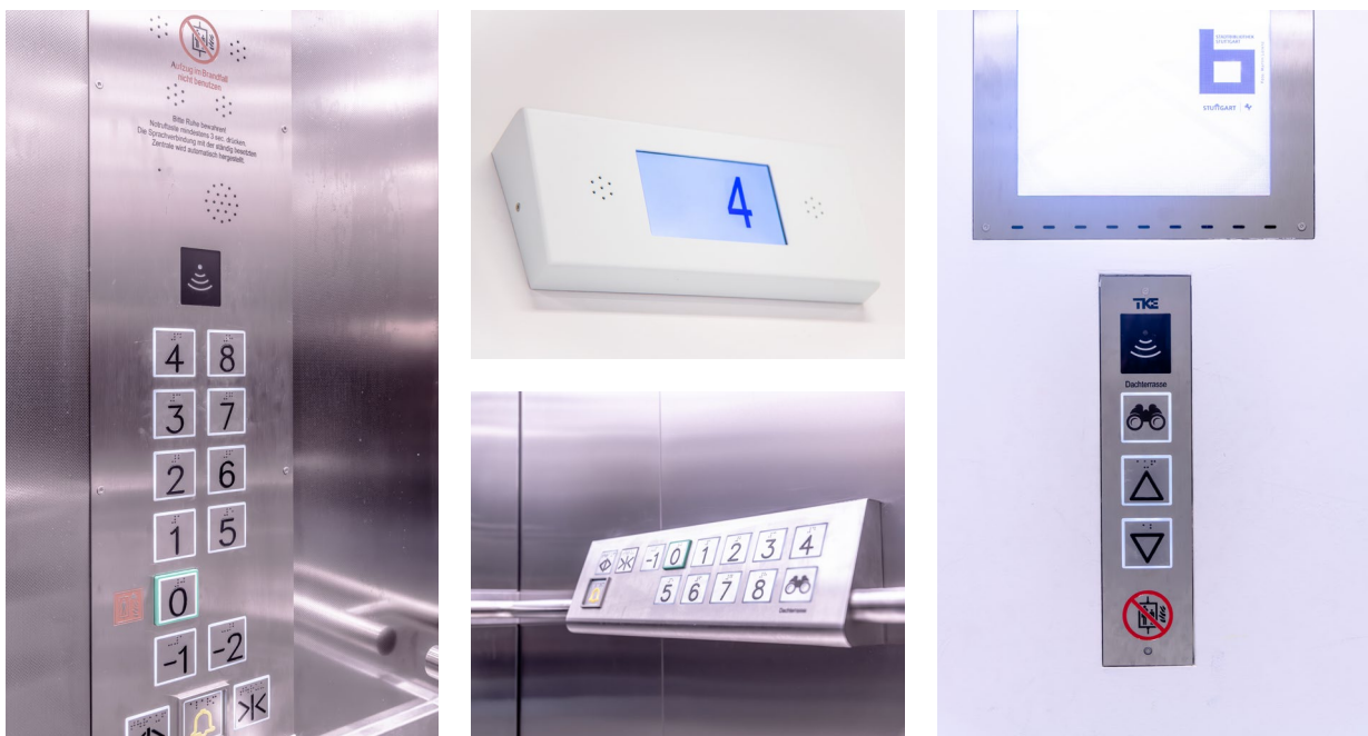
Abb. 5: NACHHER: Moderne, helle und benutzerfreundliche Anzeige- und Bedienelemente rund um die neue Aufzugsanlage
