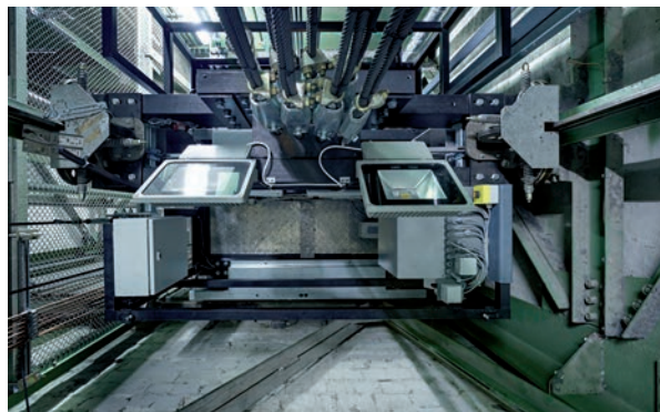
Abb.15: Scheinwerfer für Blick in den Schacht während der Fahrt nachher
