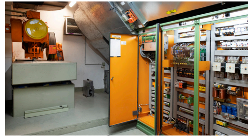
Abb. 6: Steuerung und Antrieb vorher
