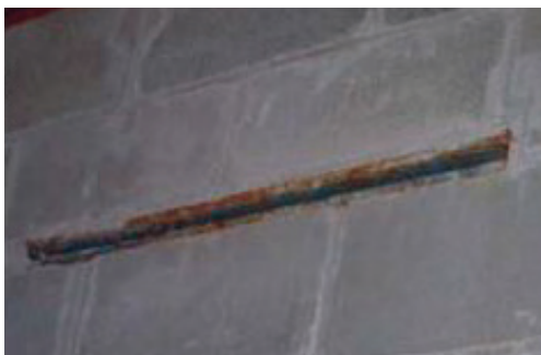
Ankereisen im Mauerwerk zwischen Steine
