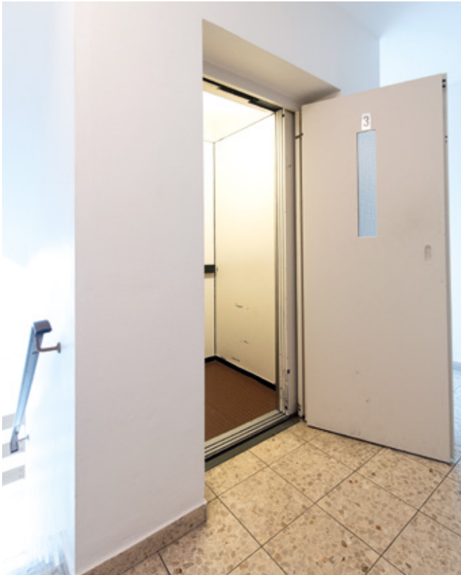
Abb.13: Versperrter Eingang vorher
