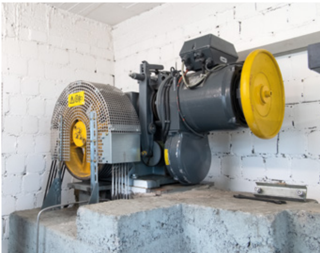
Abb.11: Antrieb vorher im extra vorgesehenen Maschinenraum
