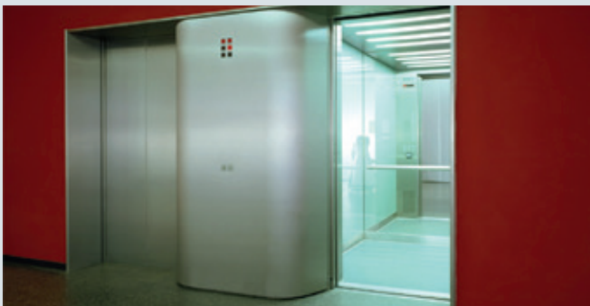
Abb.2: Blick auf das Außenportal und in die Kabine
