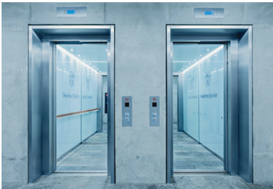
Abb.2: Im Doppelpack: Außenansicht der evolution Aufzüge mit Blick in die Kabinen
