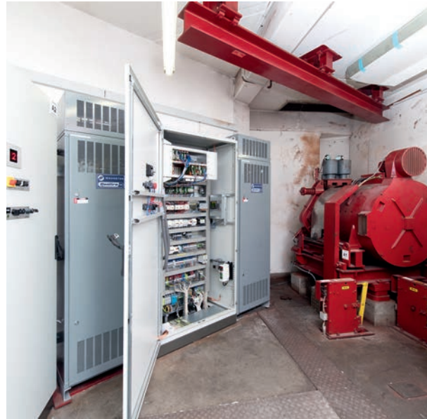
Abb.17: Maschinenraum inkl. Aufzugssteuerung nachher
