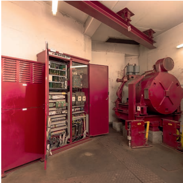
Abb.16: Maschinenraum inkl. Aufzugssteuerung vorher
