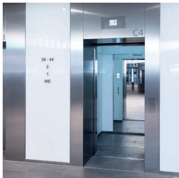
Abb.3: Aufzugskabinen in Gruppenansicht nachher
